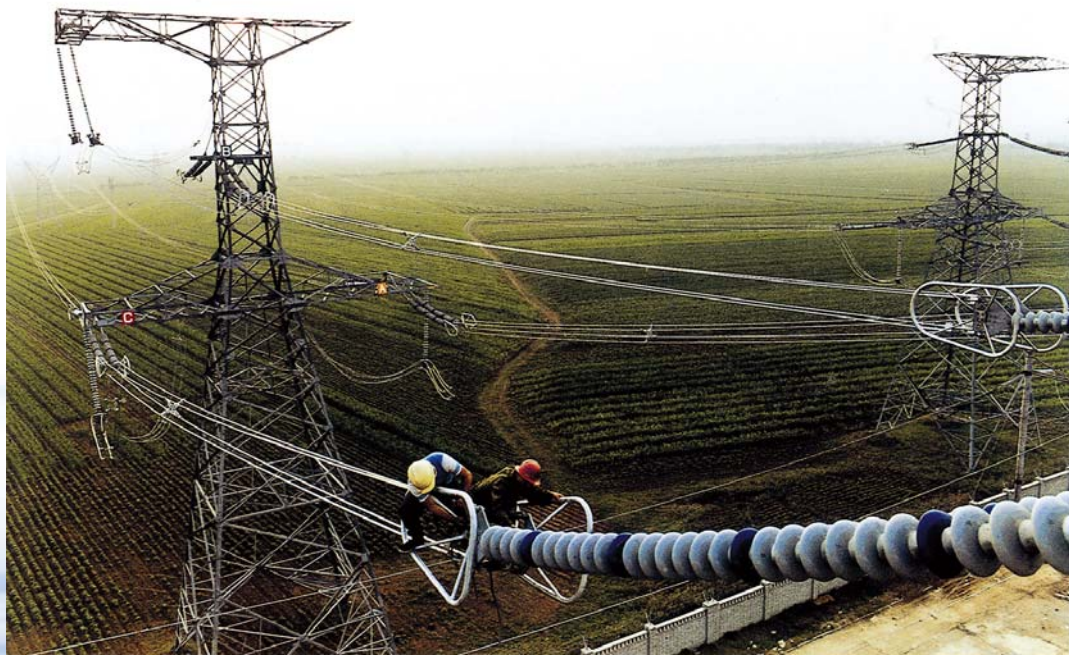
■ 1981年，我国第一条500kV超高压输电线路——平武线投入运行，1984年我国第一项自行设计、施工和采用全套国产设备的500kV元锦辽海输变电工程建成投产。图为500kV元锦辽海输电线路
